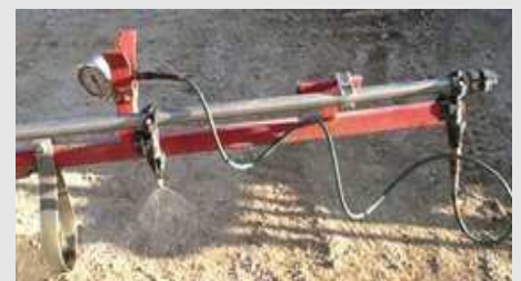
Fig. 9 – Manometro per la verifica delle perdite di carico
